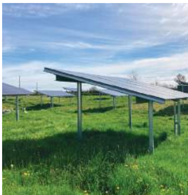
Les ombrières solaires sur le parcours des volailles apportent de l'ombre aux animaux et un revenu à l'éleveur par la vente de l'électricité produite.
