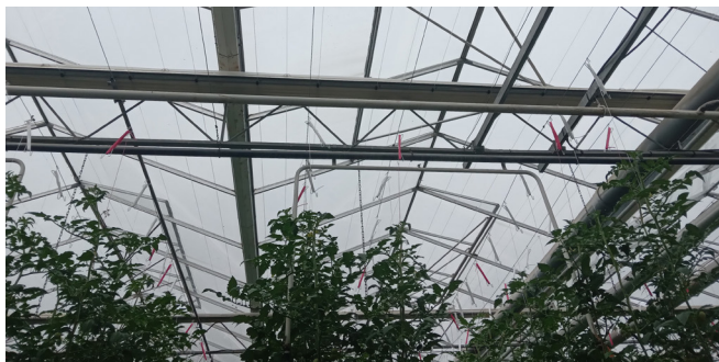
Ecran thermique / toit de la serre
