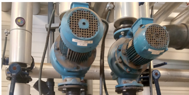
Système de pompe pour envoyer l'eau chaude dans les serres
